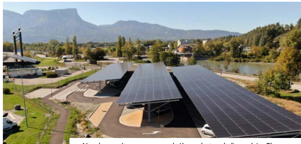
Aire de covoiturage avec ombrières photovoltaïques à La Chavanne
